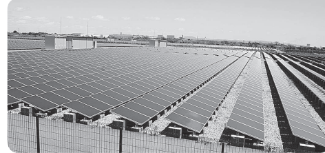
(株)関西電力堺港発電所(火力発電・太陽光発電)
